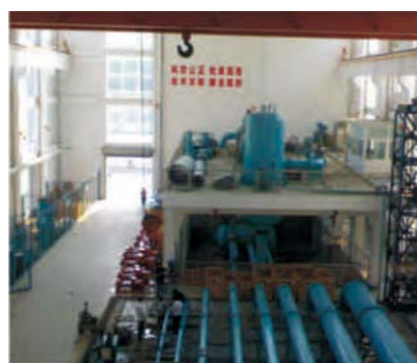
水泵测试中心
